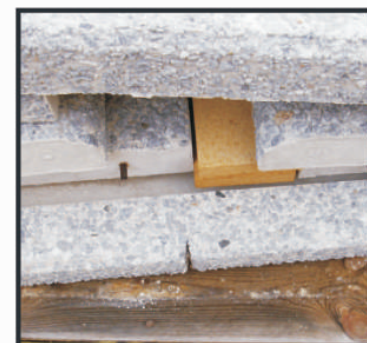
Sollbruchstelle in der Simsplatte.
