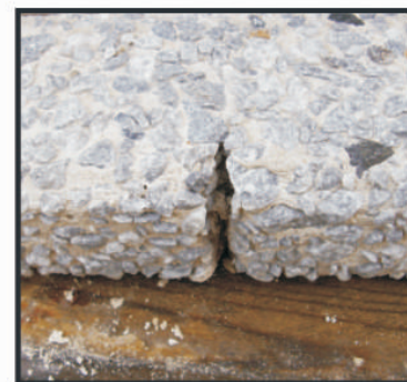
Sollbruchstelle in der Simsplatte.
