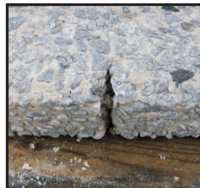
Sollbruchstelle in der Simsplatte.
