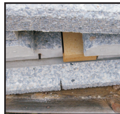
Sollbruchstelle in der Simsplatte.
